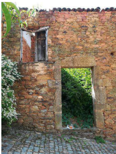
Foto 2. Pormenor de vãos e telhas no beirado.
