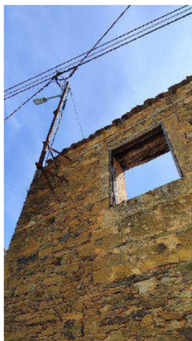
Foto 9. Estrutura metálica para iluminação
